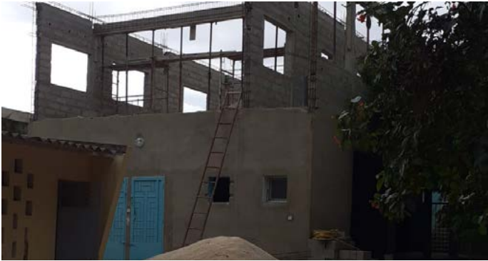
Šolska stavba je v gradnji, potem pa pride na vrsto še jedilnica.
